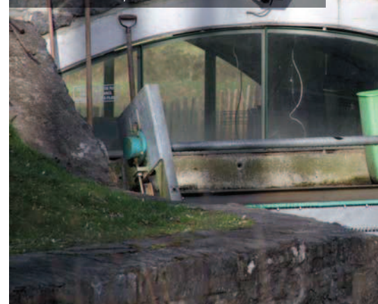
La trémie de récupération des déchets
