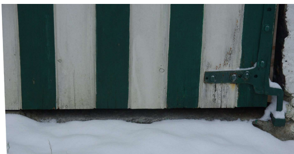
Photo 2 : Non d'équerres, seuil, porte et murs offrent des passages aisés à franchir par les surmulots.
