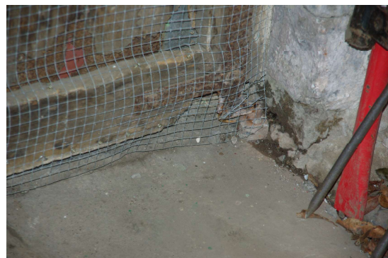
Photo 3 : Grillage disposé derrière la porte pour limiter les allers et venues des rongeurs.
